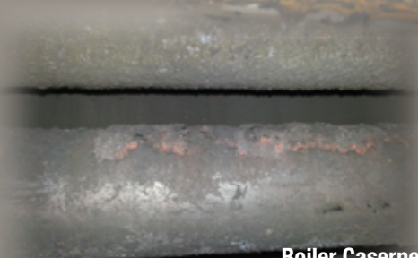
Boiler Caserne Grand-Duc Jean Diekirch
